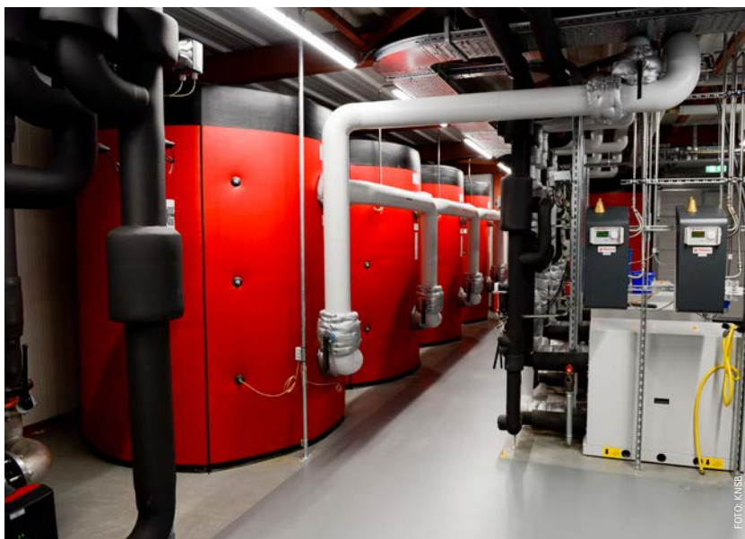
Warmteopslagvaten in ijsbaan De Meent in Alkmaar.
